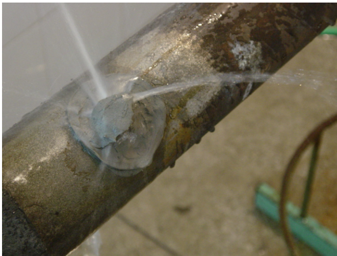
Fig. A.12 – Falha total do reparo. BELZONA 1111.
