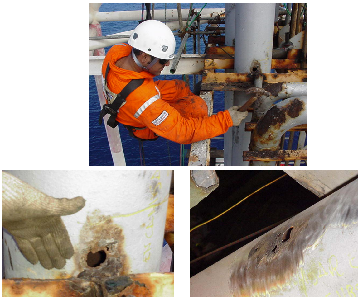
Figura 1.2 – Dano por corrosão em tubulações para água produzida.
