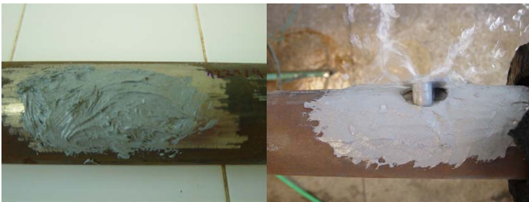
Figura A.5 - falha dos sistema de reparo com o adesivo BELZONA 1221
