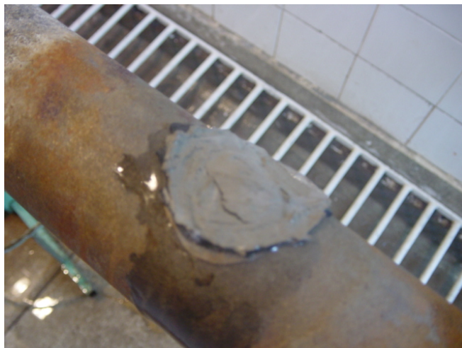
Fig. A.10 - Falha do Reparo (pequeno vazamento). BELZONA 1111.
