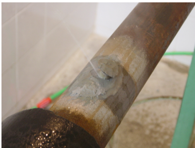
Fig. A.11 – Falha total do reparo. BELZONA 1111.
