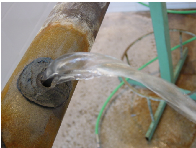
Figura A.16 – Falha total do reparo. MM-METAL SS AÇO CERÂMICA.
