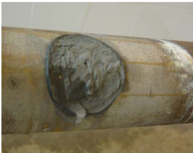
Fig. A.14 - Falha do Reparo (pequeno vazamento). MM-METAL SS AÇO CERÂMICA
