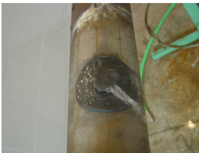
Figura A.15 – Falha total do reparo. MM-METAL SS AÇO CERÂMICA
