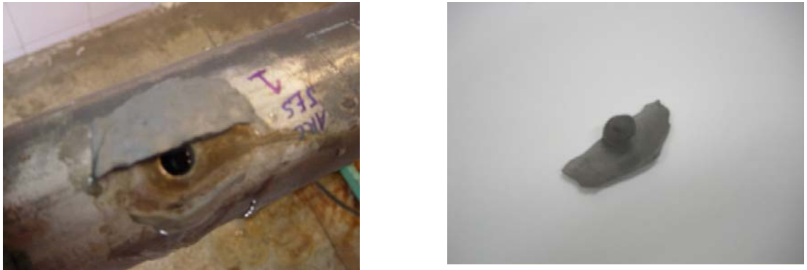
Figura. A.1 – Falha do adesivo ARC 5ES
